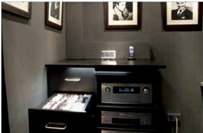
Die AV-Geräte sind in einem maßgeschneiderten Schrank im Technik-Nebenraum untergebracht. Er bietet auch Platz für die Filmsammlung.
