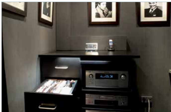
Die AV-Geräte sind in einem maßgeschneiderten Schrank im Technik-Nebenraum untergebracht. Er bietet auch Platz für die Filmsammlung.
